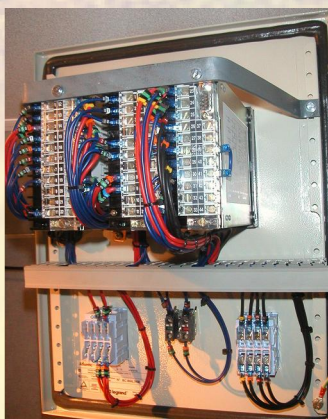
Vue du câblage des relais et des automatismes d'un coffret GTE1.3 et de la barre de calage pour le transport
