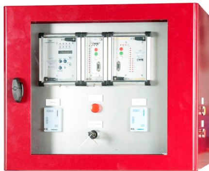
Coffret de découplage GTE 1.4/RE prévu pour le recouplage automatique au réseau public de la centrale de production
